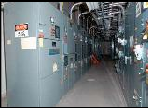
SQUARE D SWITCHGEAR
