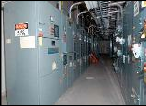
SQUARE D SWITCHGEAR
